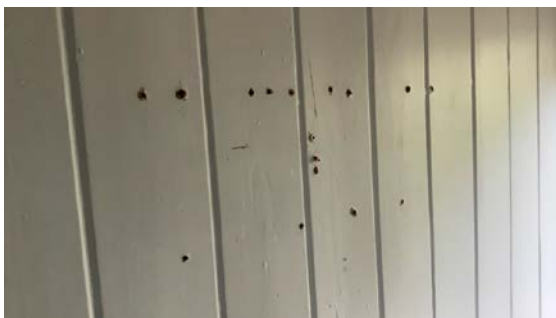
Mange skruehull i vegg.
