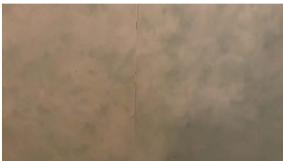
Utette skjøter i belegg/tapet.
