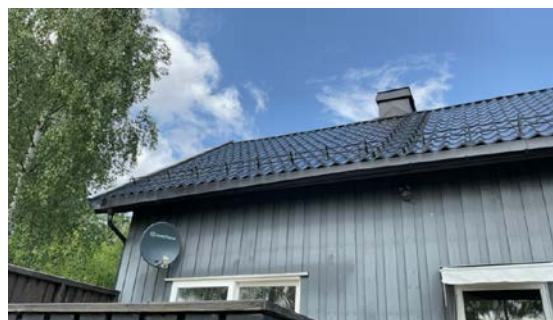
Eksempel på deformasjoner på takrenner.
