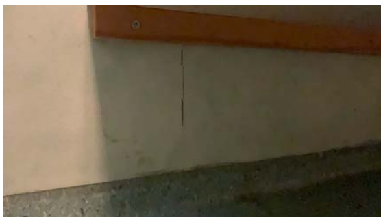
Utette skjøter i belegg/tapet.
