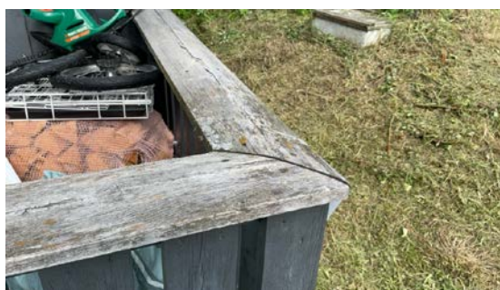
Sprekker i eldre håndrekke.
