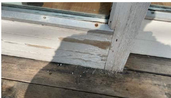
Slittasje i treverk på terrassedør.
