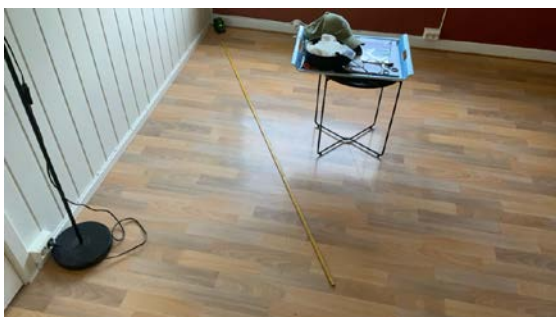
Meterstokk viser hvor avvik er registrert.
