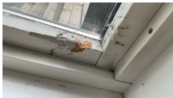
Skade i vindu.
