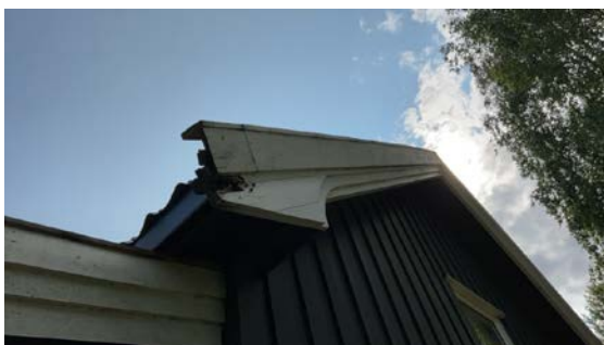
Råteskader i vindskier/bordkledning.
