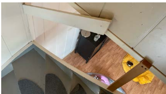
Store åpninger i rekkverk.
