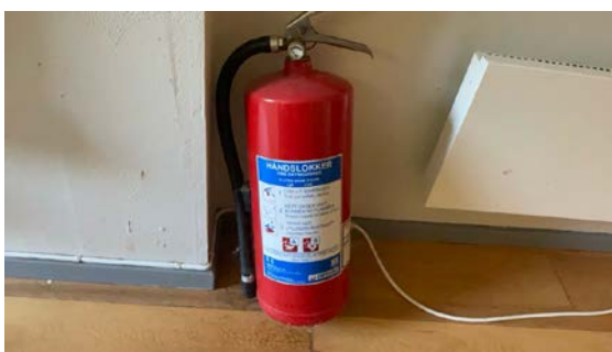
Apparat fra 1999. Bør byttes.
