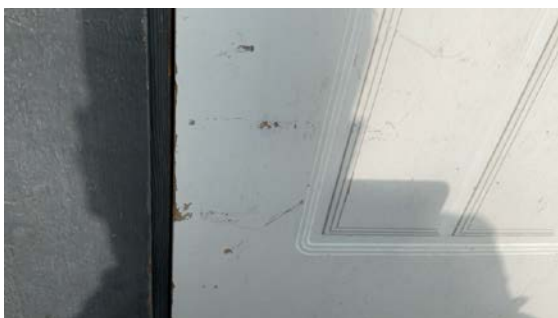
Skader i ytterdør.
