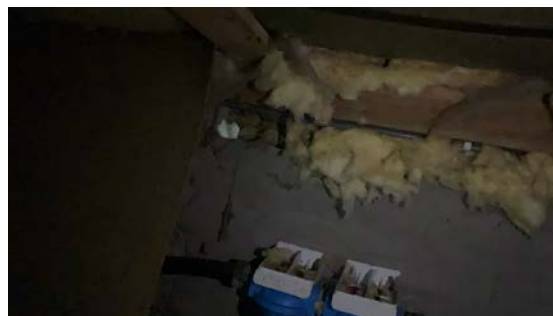
Ventilluke delvis tettet med isolasjon.
