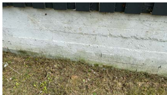
Ingen synlig grunnmursplast over terreng.
