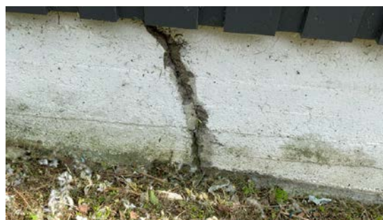
Eksempel på store sprekker/riss i grunnmur.
