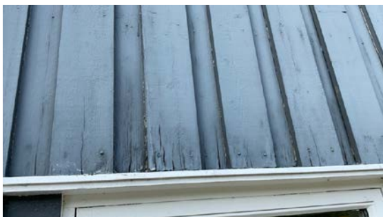
Råteskadet kledning på vegg.
