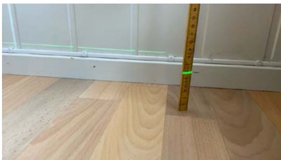
Det er målt 6cm ved utgangspunkt.
