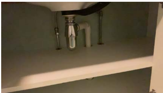
Vannledninger av kobber.
