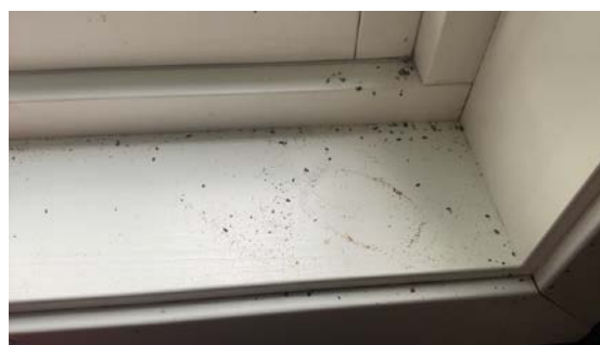
Muselort i vinduskarm i 2 etasje.
