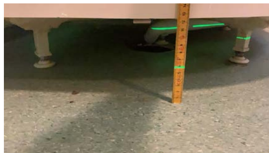
Det er målt 6cm på gulv ved slukrist. Ca 30cm ifra.
