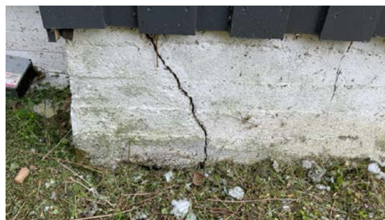
Eksempel på store sprekker/riss i grunnmur.
