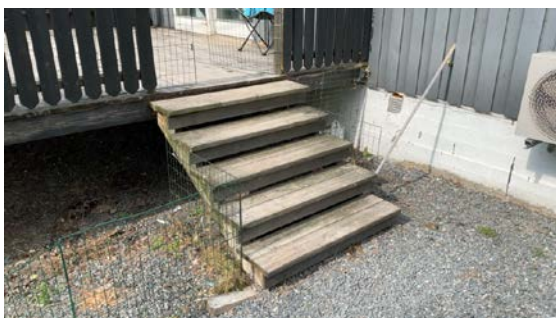
Trapp mangler rekkverk.
