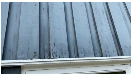
Råteskadet kledning på vegg.
