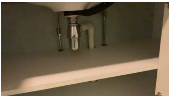
Vannledninger av kobber.
