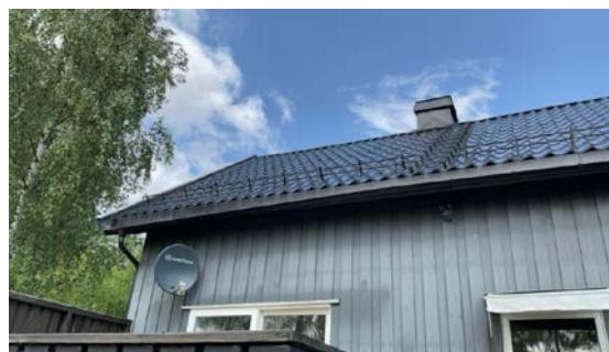
Eksempel på deformasjoner på takrenner.
