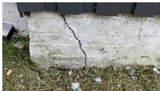
Eksempel på store sprekker/riss i grunnmur.
