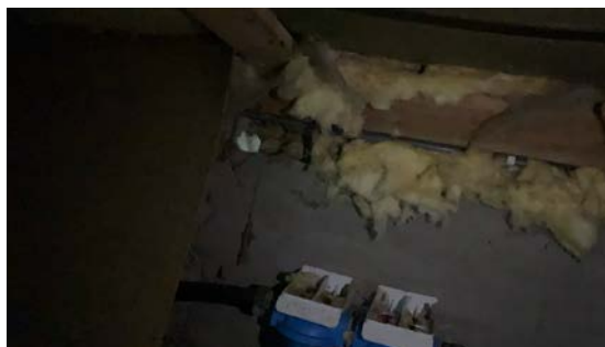
Ventilluke delvis tettet med isolasjon.
