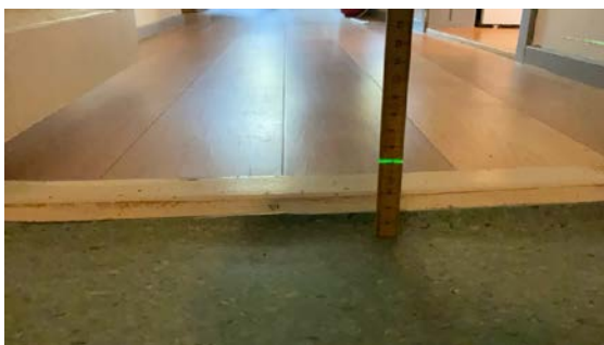
Det er målt 5,0cm på gulv ved terskel.
