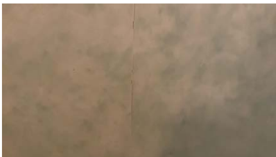
Utette skjøter i belegg/tapet.
