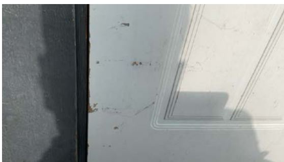
Skader i ytterdør.
