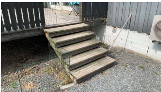
Trapp mangler rekkverk.
