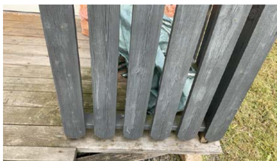
Sprekker i trevirke.
