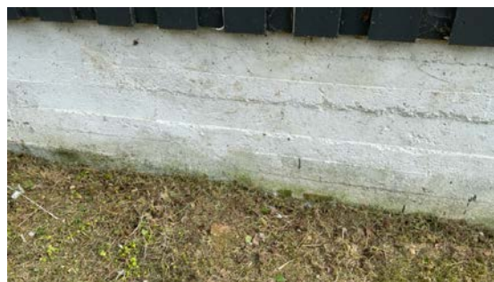
Ingen synlig grunnmursplast over terreng.
