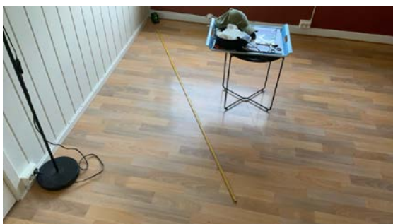
Meterstokk viser hvor avvik er registrert.
