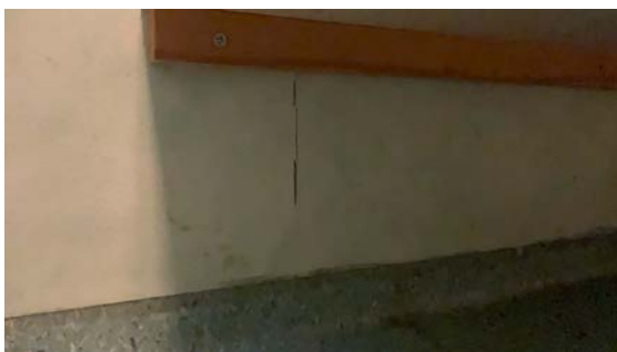
Utette skjøter i belegg/tapet.
