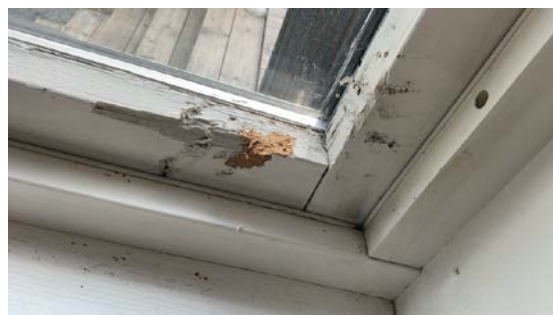
Skade i vindu.
