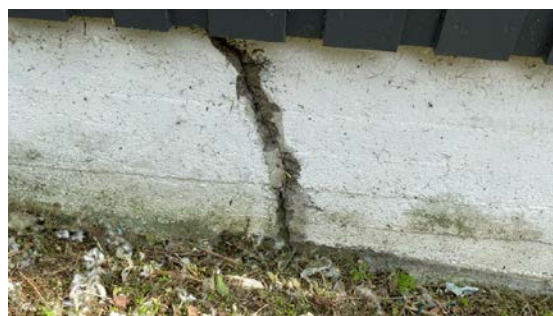
Eksempel på store sprekker/riss i grunnmur.
