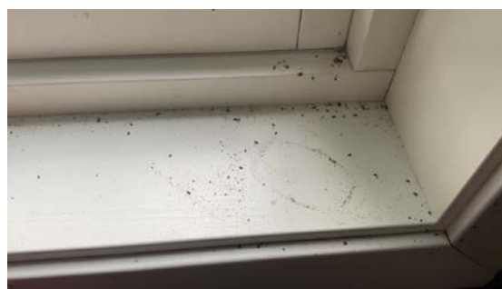
Muselort i vinduskarm i 2 etasje.
