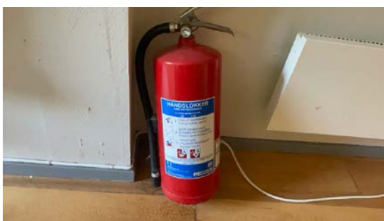
Apparat fra 1999. Bør byttes.
