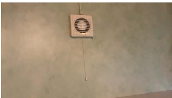
Elektrisk styrt vifte.
