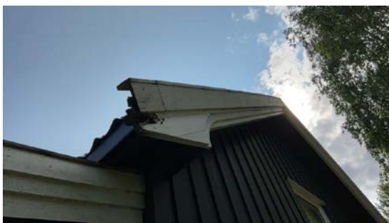
Råteskader i vindskier/bordkledning.
