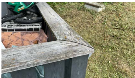
Sprekker i eldre håndrekke.
