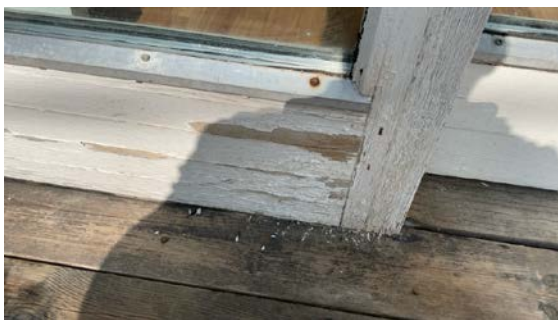
Slittasje i treverk på terrassedør.
