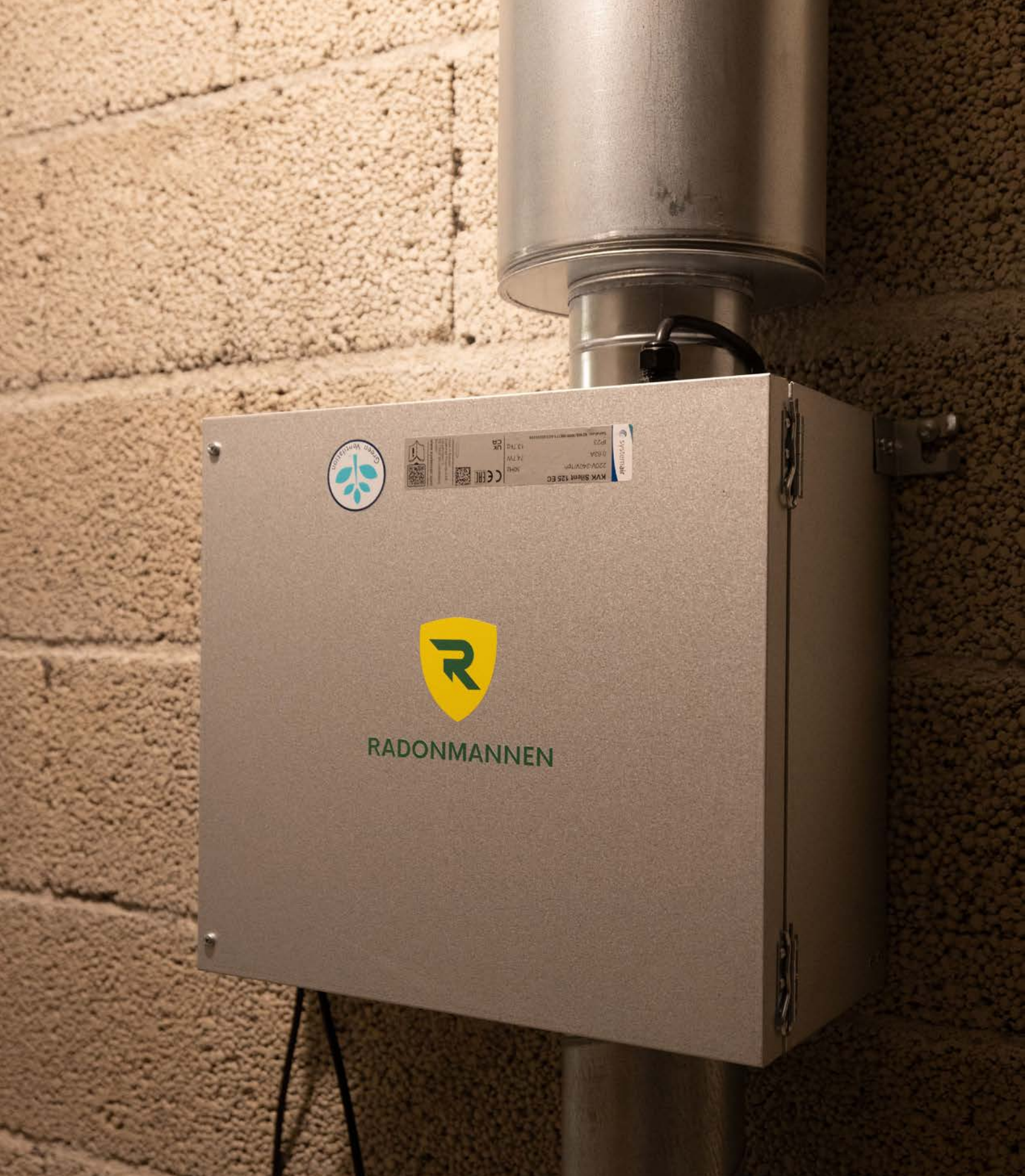
Det er installert radonbrønn. Etter nylige målinger har denne hatt ønsket effekt.
