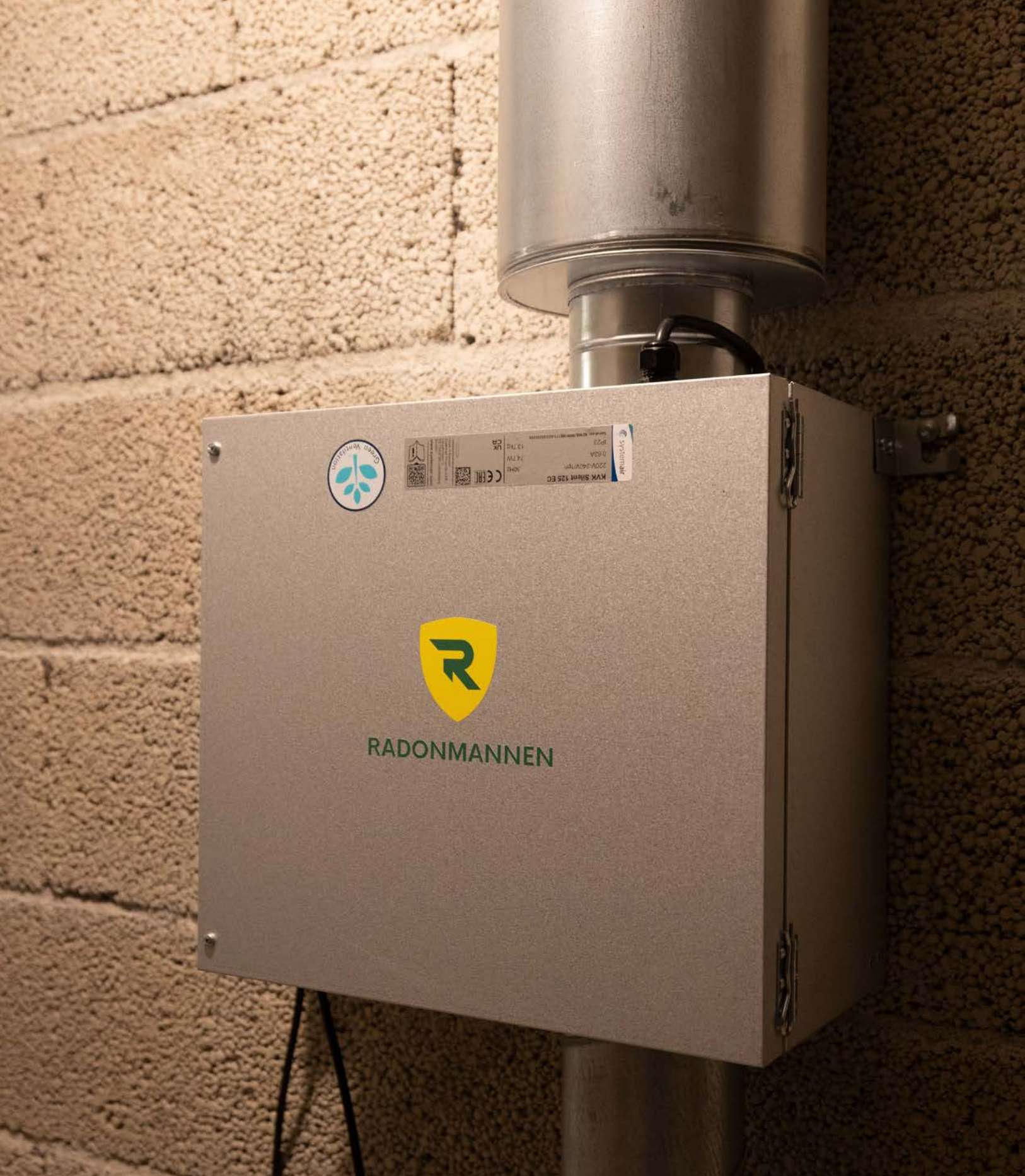
Det er installert radonbrønn. Etter nylige målinger har denne hatt ønsket effekt.
