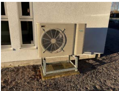
Utvenbdig del på varmepumpe.
