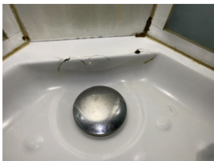
Skadet bunn i dusjkabinett.
