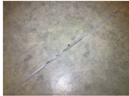
Tegn til glippe i sveiseskjøt.
