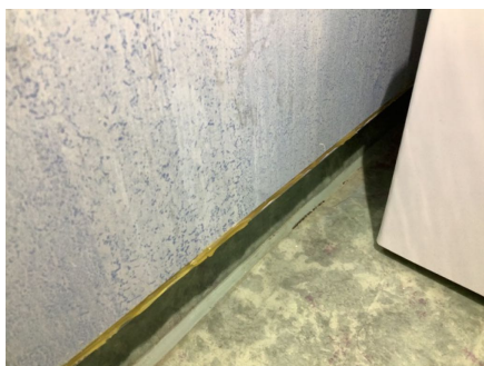
Tegn til glippe i sveiseskjøt.
