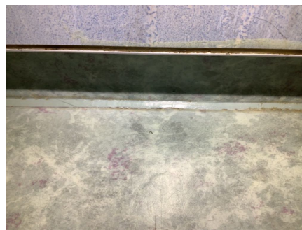
Tegn til glippe i sveiseskjøt.
