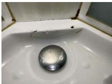
Skadet bunn i dusjkabinett.
