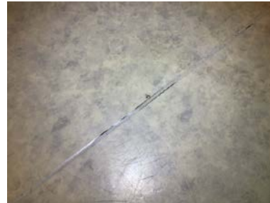
Tegn til glippe i sveiseskjøt.
