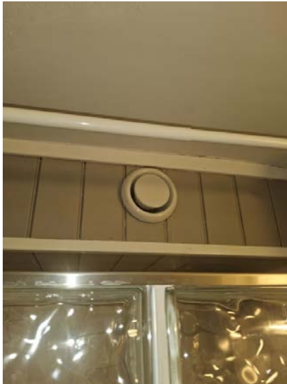
Felles mekanisk avtrekk på bad.
