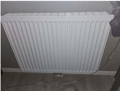
Leiligheten er i hovedsak oppvarmet med radiatorer.
