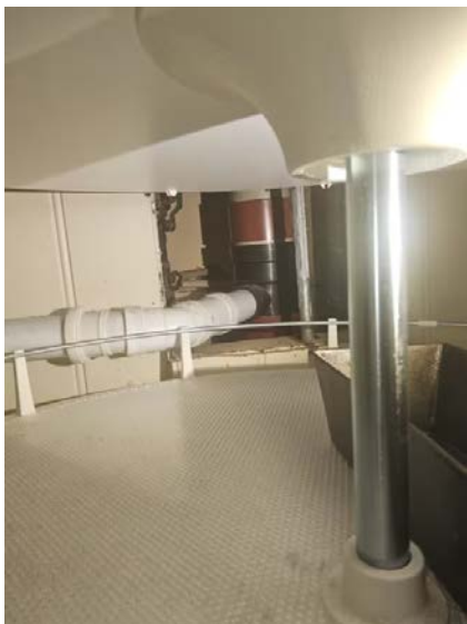
Stoppekraner er plassert i sjakt bak kjøkkeninnredning.
