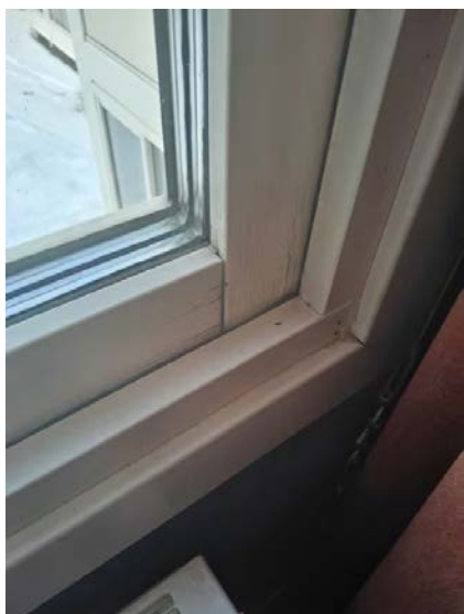
Vindu på soverom har skader i overflatebehandling.
