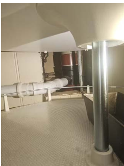
Det registreres avløpsrør med lite fall i kjøkkeninnredning.
