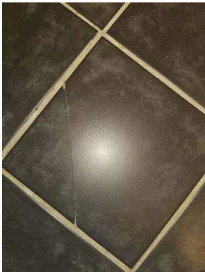
Det registreres en sprekt gulvflis.
