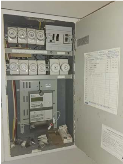
Sikringsskap er plassert i felles gang.
