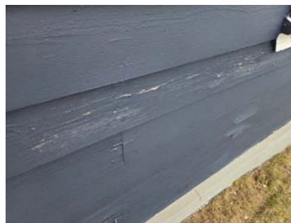
Værslitt panel sørvegg.
