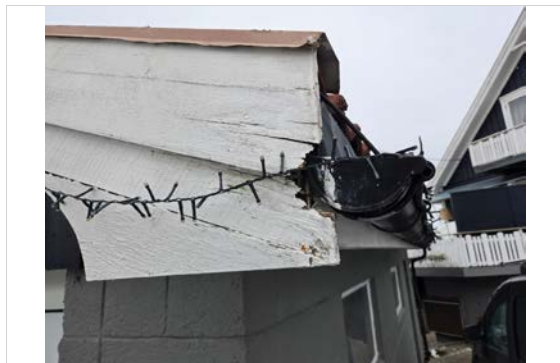
Mindre synlig råte i vindskiebord.
