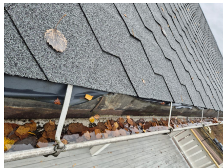
Avflasset belegg på takfotbeslag.
