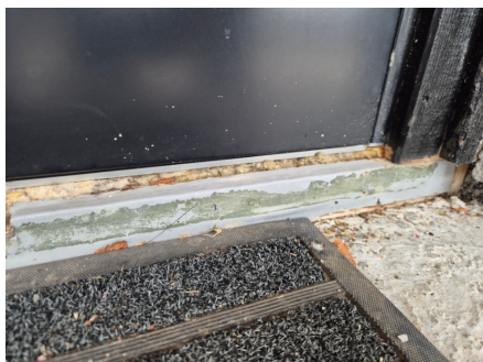
Mangler beslag i underkant av dør.
