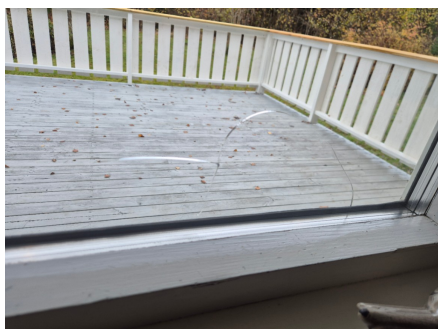
Sprukket glass i stuevindu.
