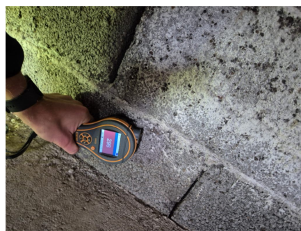
Synlig saltutslag i utvendig bod.
