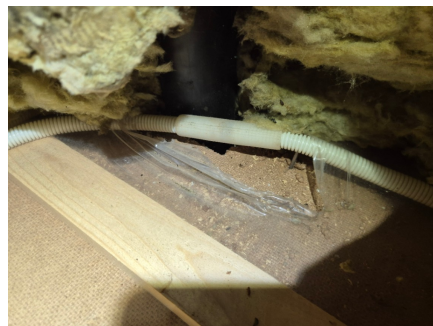
Brudd på dampsperre.
