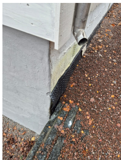
Ikke kontrollert bortledning av vann fra taknedløp.
