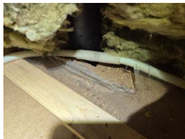
Brudd på dampsperre.
