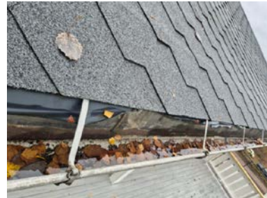
Avflasset belegg på takfotbeslag.
