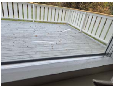
Sprukket glass i stuevindu.
