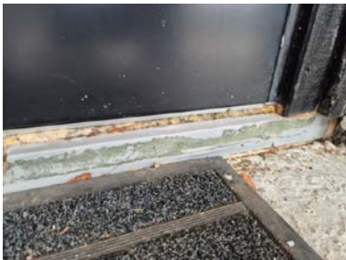
Mangler beslag i underkant av dør.
