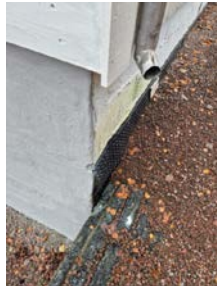
Ikke kontrollert bortledning av vann fra taknedløp.
