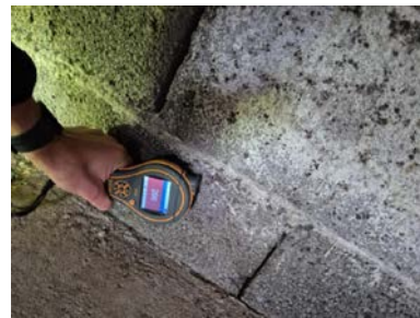
Synlig saltutslag i utvendig bod.
