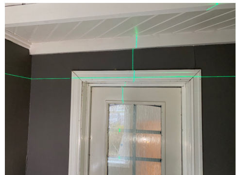
Skjevheter i taket
