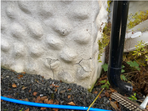
Sprekk/riss i mur.
