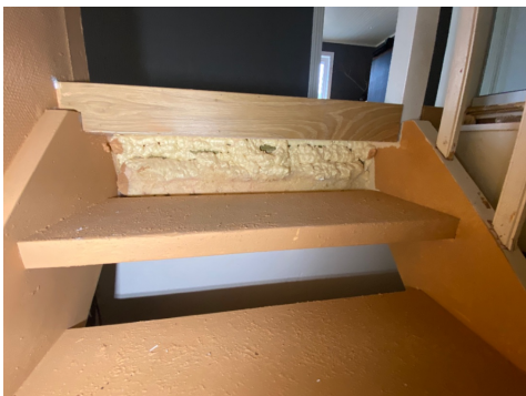
Synlig byggsaum, ujevnheter i overlate trinn.
