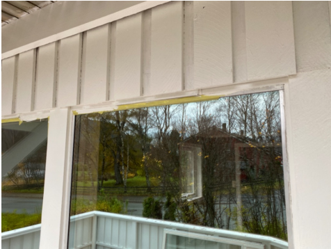
Vinduer mangler beslag/vannbrett.
