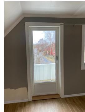
Stedvis manglende ferdiggjstillelse av malingsarbeider.
