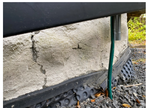
Sprekk/riss i mur.
