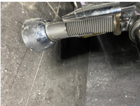
R rapplegget er ikke fagmessig utf rt.
