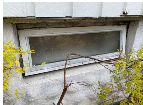
Manglende beslag i nedkant av kjellervinduer.
