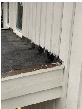
Manglende beslag mellom vegg og tak.
