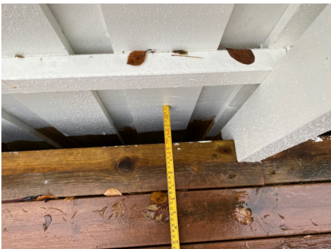
Åpning mellom dekket og rekkverk.
