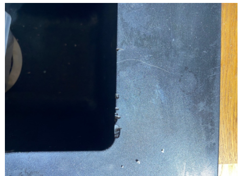
Skade i oppvaskkummen
