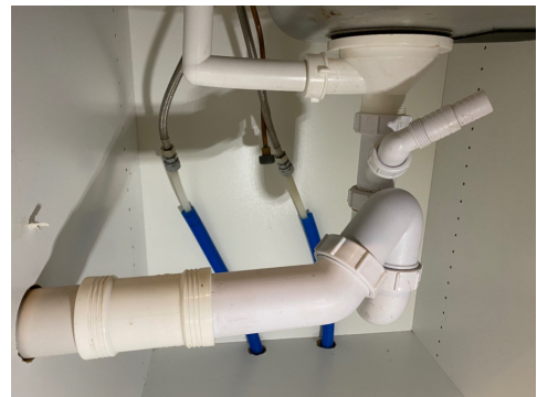
Det mangler tettemuffer i enden av varer r p  r r-i-r r-system.
