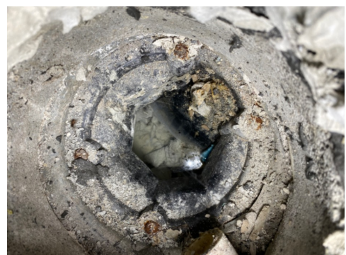
Sluk ved toalett.
