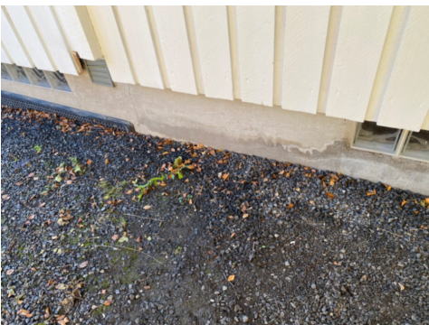
Fuktsikring mot muren mangler stedvis.
