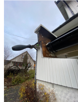
Påbegynte råteskader i dekkbord og vindskie.
