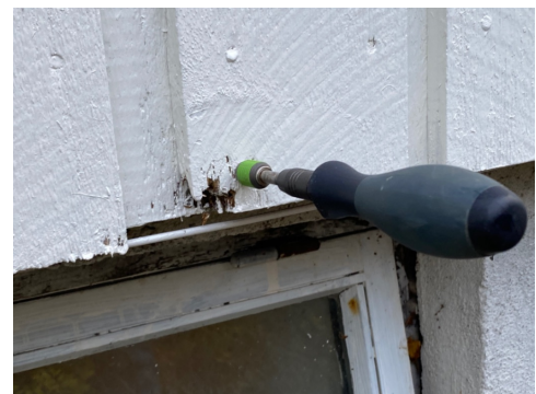
Kledningen har stedvis råteskader
