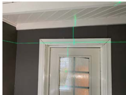
Skjevheter i taket
