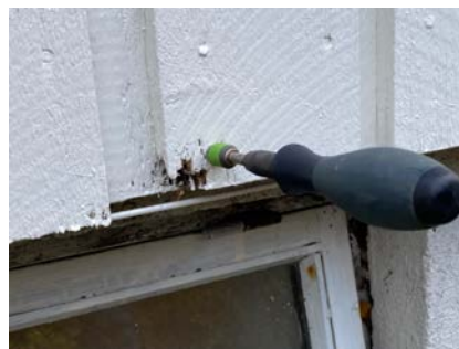
Kledningen har stedvis råteskader
