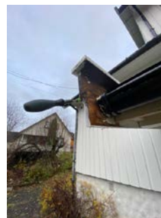
Påbegynte råteskader i dekkbord og vindskie.
