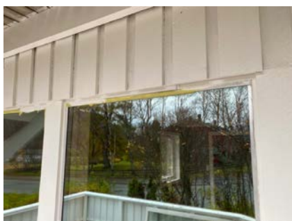
Vinduer mangler beslag/vannbrett.
