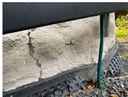
Sprekk/riss i mur.
