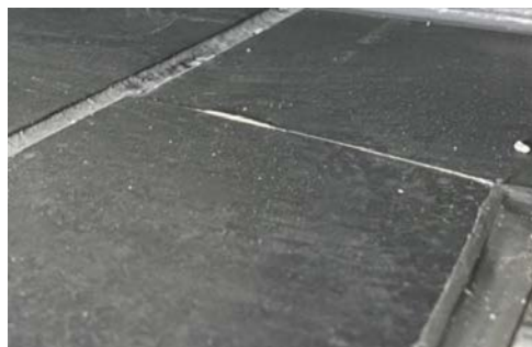
Sprekk i flis.
