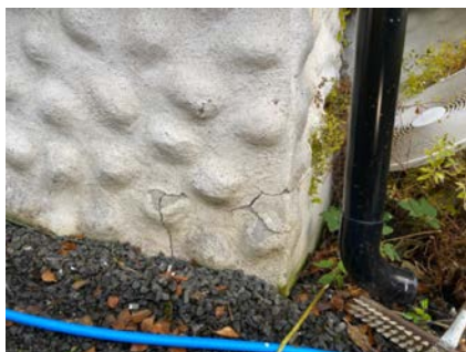
Sprekk/riss i mur.
