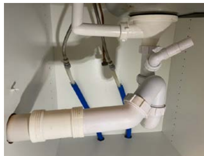
Det mangler tettemuffer i enden av varerør på rør-i-rør-system.
