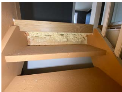
Synlig byggsaum, ujevnheter i overlate trinn.
