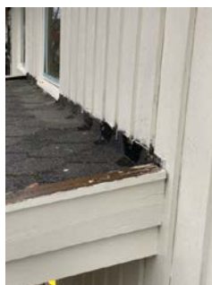
Manglende beslag mellom vegg og tak.
