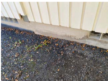
Fuktsikring mot muren mangler stedvis.
