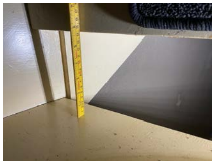
Åpninger mellom trinn
