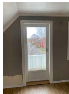
Stedvis manglende ferdiggjstillelse av malingsarbeider.
