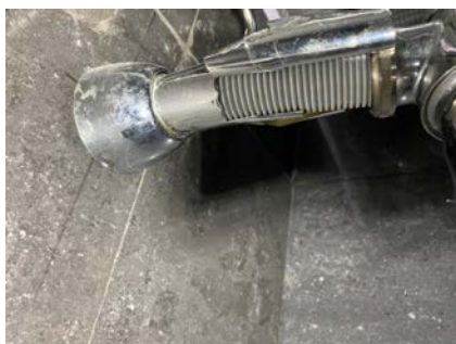
Røropplegget er ikke fagmessig utført.
