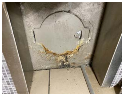
Saltutslag/løs murpuss, påbegynt rust i sotluke.
