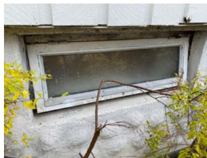
Manglende beslag i nedkant av kjellervinduer.
