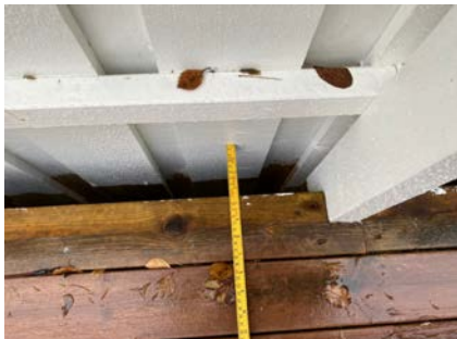
Åpning mellom dekket og rekkverk.
