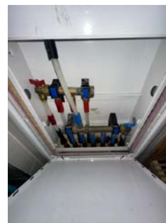
Samleskap med rørkurser og stoppekraner
