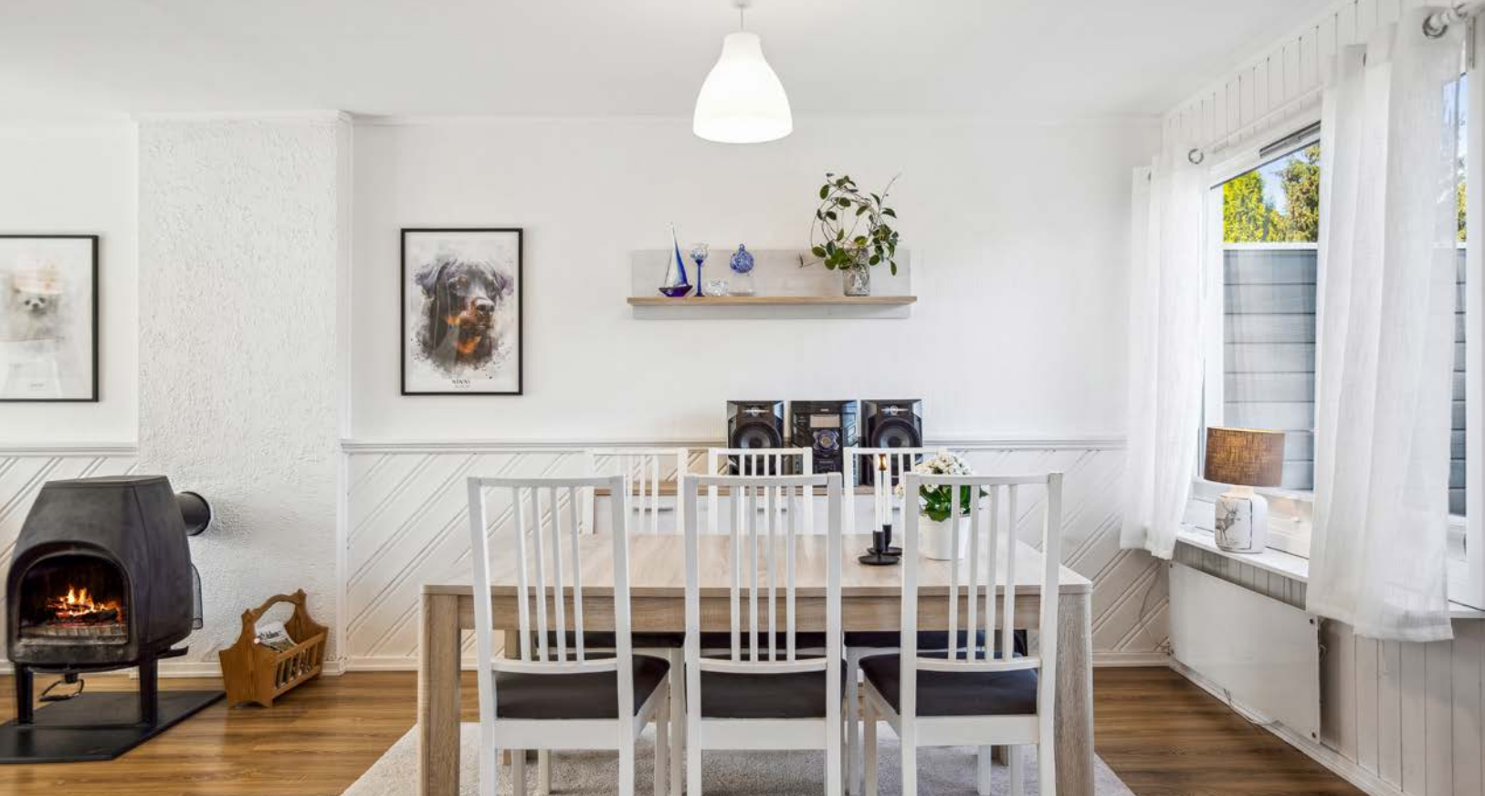
Mellom stue og spisestue er en vedovn. I tillegg er det panelovner, og varmekabler på gulv i kjøkken.
