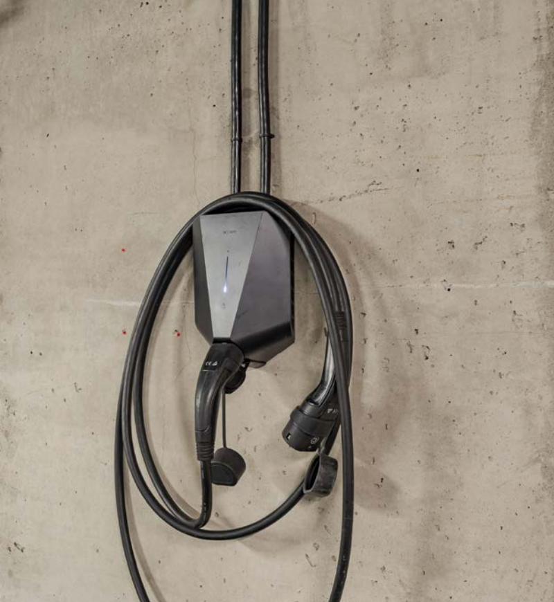
Det er montert elbil-lader.
