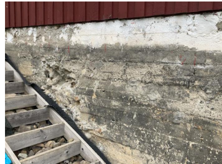
Grunnmur mot nord har skader/avskalling. Betong har redusert kvalitet grunnet mye kulestien.
