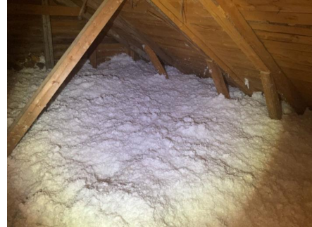
Ingen lufting mot skråtak.
