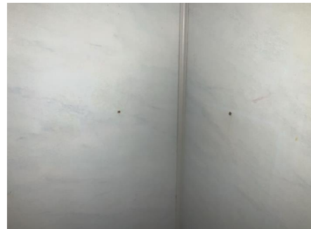
Hull i baderomsplater/tettesjikt på vegg i dusjonen.
