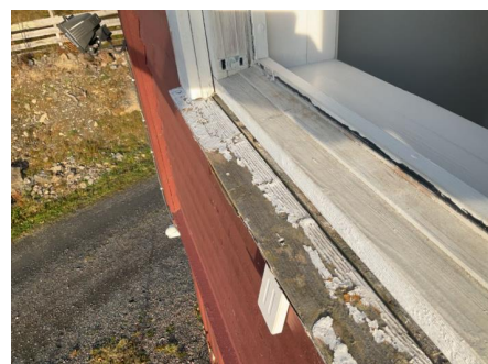
Vindu i 2. etasje mot nord, ingen beslag på vannbrett og glippe mellom vannbrett og vinduskarm.
