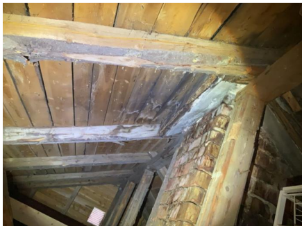
Misfarging/fuktmerker i himling nedenfor pipe.
