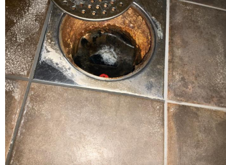
Sluk har ingen synlig membran/tettesjikt.
