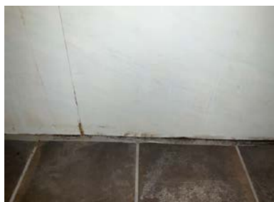
Muggsopp i bunn av baderomsplater og på silikonfuger i dusjsjonen.
