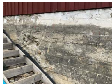
Grunnmur mot nord har skader/avskalling. Betong har redusert kvalitet grunnet mye kulestien.
