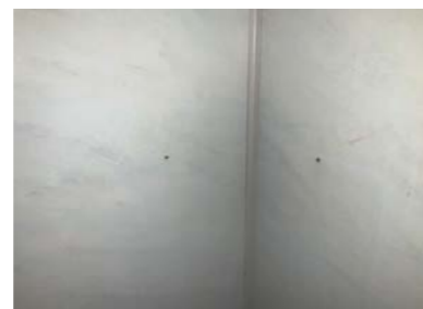
Hull i baderomsplater/tettesjikt på vegg i dusjsjonen.
