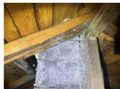
Pipe mot sør er rehabilitert med lettklinkerelementer over tak og røykrør av leca.
