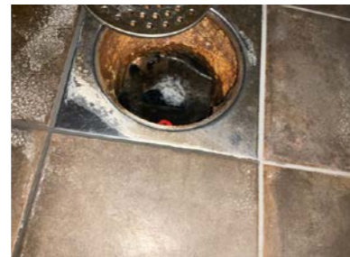
Sluk har ingen synlig membran/tettesjikt.
