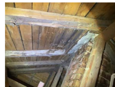
Misfarging/fuktmerker i himling nedenfor pipe.
