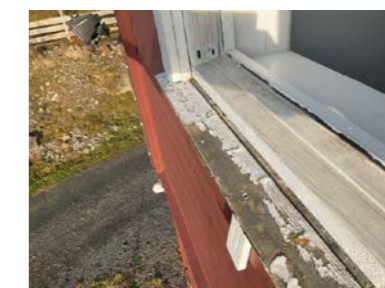
Vindu i 2. etasje mot nord, ingen beslag på vannbrett og glippe mellom vannbrett og vinduskarm.
