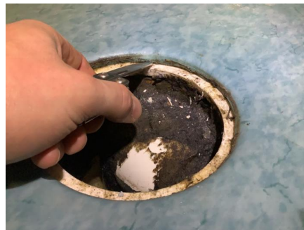
Utett tilslutning mellom vinylbelegg og sluk.
