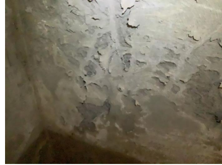
Eksempel på saltutslag
