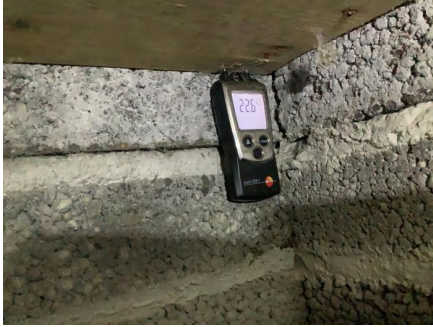
Skadelig fuktinnhold i panel i himling.
