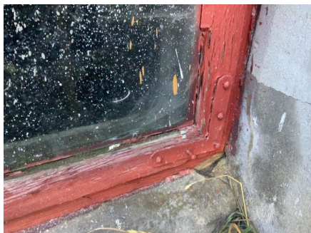
Eksempel på værslitt kjellervindu.
