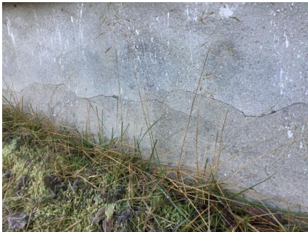
Eksempel på utvendig horisontalriss.
