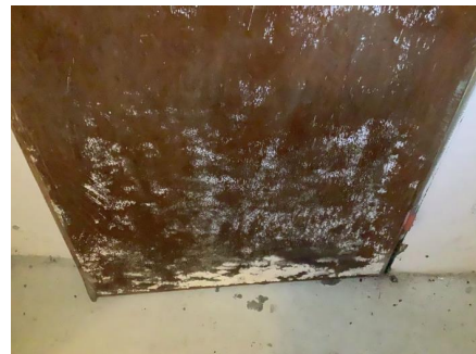
Fuktskadet dørblad på samme dør.
