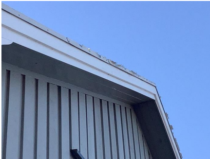
Lakk har løsnet fra vindskibeslag.
