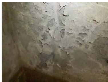
Eksempel på saltutslag
