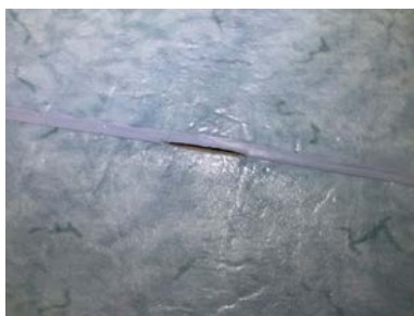
Utett sveis i vinylbelegget.
