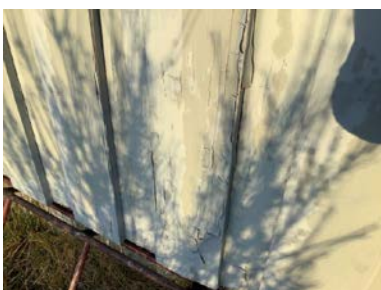
Eksempel på værslitt bordkledning med løsnet maling.
