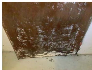
Fuktskadet dørblad på samme dør.
