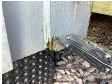
Eksempel på råteskadet bordkledning.
