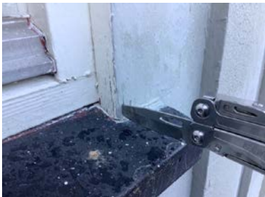
Omramming rundt vindu er ført helt ned til vannbrett, og dette har ført til spredte råteskader.
