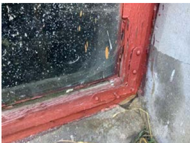
Eksempel på værslitt kjellervindu.
