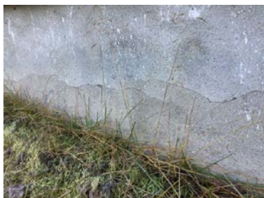
Eksempel på utvendig horisontalriss.
