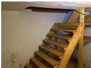
Kjellertrapp mangler rekkverk og håndløper på vegg.
