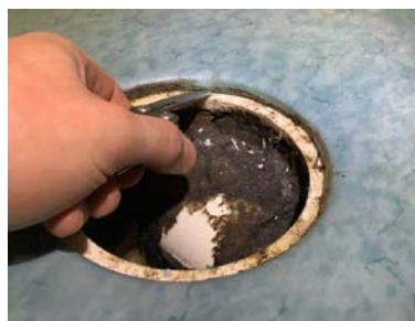
Utett tilslutning mellom vinylbelegg og sluk.
