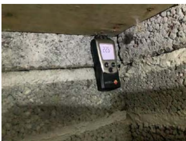
Skadelig fuktinnhold i panel i himling.
