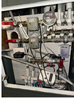
Samleskap med rørkurser og stoppekraner
