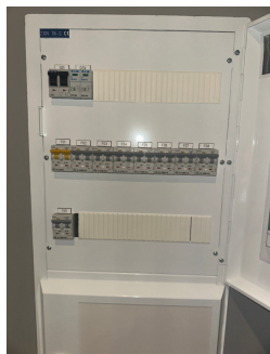
Sikringsskap med automatsikringer.
