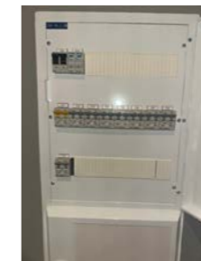
Sikringsskap med automatsikringer.
