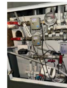
Samleskap med rørkurser og stoppekraner
