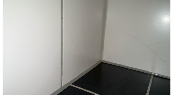
Sprekker i fliser ved klosett.
