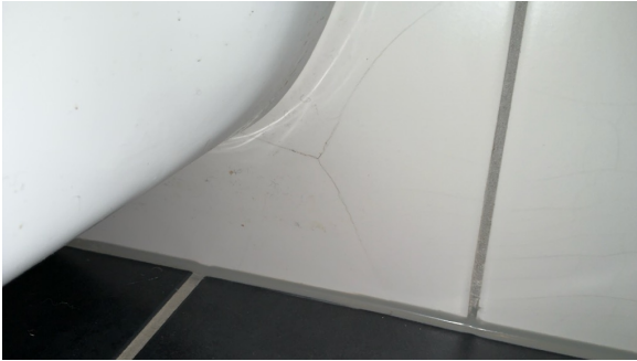
Sprekker i fliser ved klosett.
