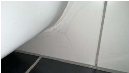
Sprekker i fliser ved klosett.
