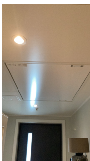
Ventilasjonsenhet i himling i gang.
