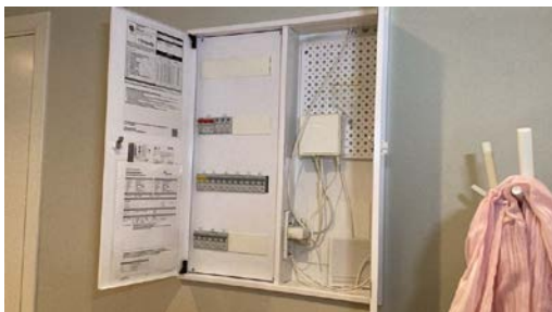
Sikringsskap i gang.
