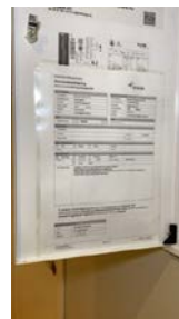
Samsvarserklæring datert 30. august 2022 ligger i sikringsskap.
