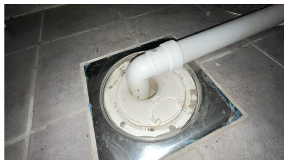
Sluk under vaskemaskin
