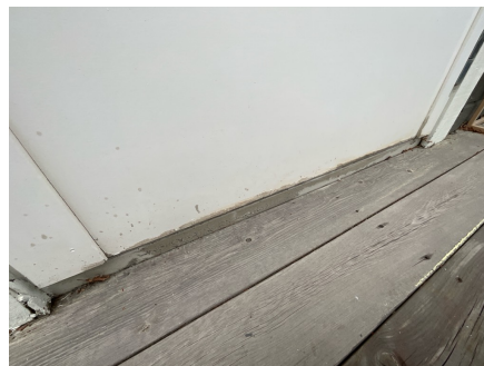
Værslitasje i bunn av balkongdør
