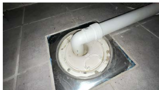
Sluk under vaskemaskin
