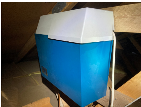
Oljeløfter, montert på loft. Tank er kobla tømt
