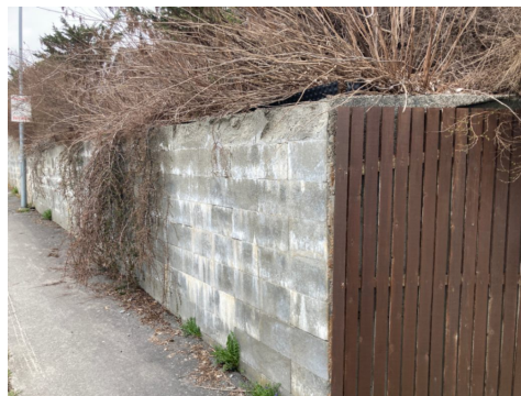
Skade/avskalling i mur i betongstein
