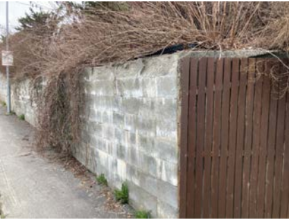
Skade/avskalling i mur i betongstein
