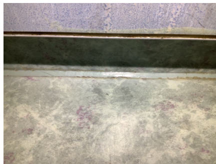
Tegn til glippe i sveiseskjøt.
