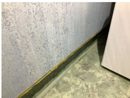
Tegn til glippe i sveiseskjøt.
