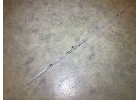
Tegn til glippe i sveiseskjøt.
