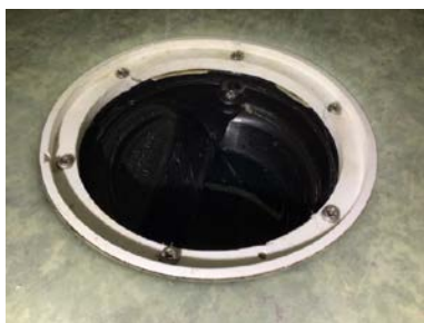
Plastsluk, og vinylbelegg er ført under slukets klemring.
