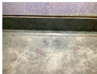
Tegn til glippe i sveiseskjøt.
