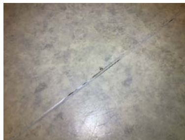
Tegn til glippe i sveiseskjøt.
