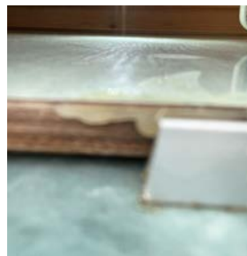
Vegger rundt badekar har sokkellist, mens baderomsplater på vegger ellers ikke er forseget i nedkant.
