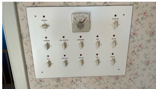
Tavle for varmefolie og forbruk på kjøkkenet.
