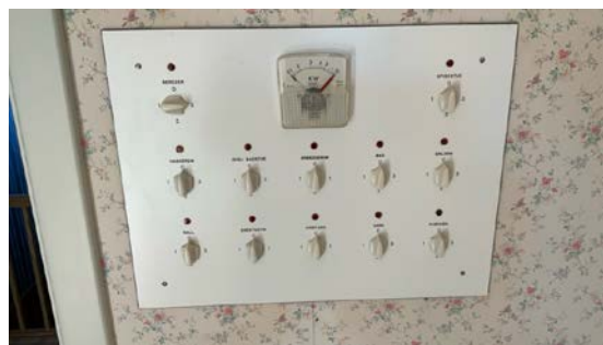
Tavle for varmemefolie og forbruk på kjøkkenet.
