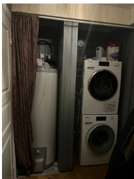
Nisjer til bereder og vaskemaskin.
