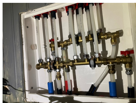
Fordelerskap med stoppekran, funksjonstestet ok.
