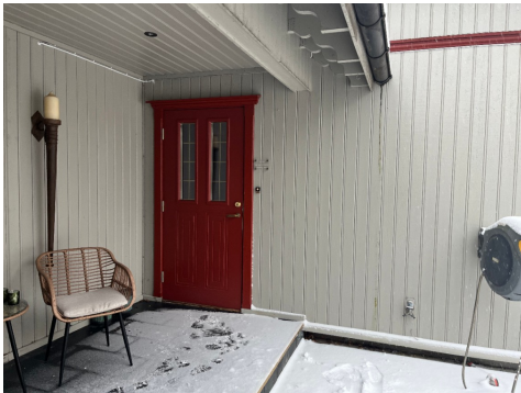
Tegn på lekkasje fra takrenne.
