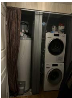
Nisjer til bereder og vaskemaskin.
