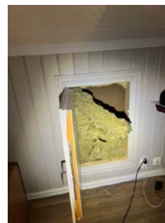
Luker til kneloft er tett med vindtettplate.
