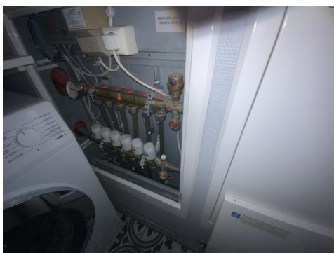
Skap for radiatorvarme
