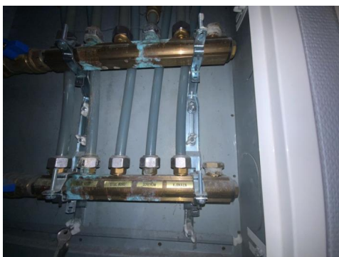
Skap for gulvvarme.
