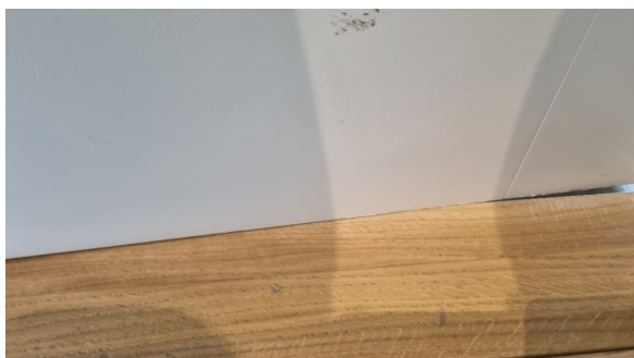
Enkelte dører subber mot karm/terskel.
