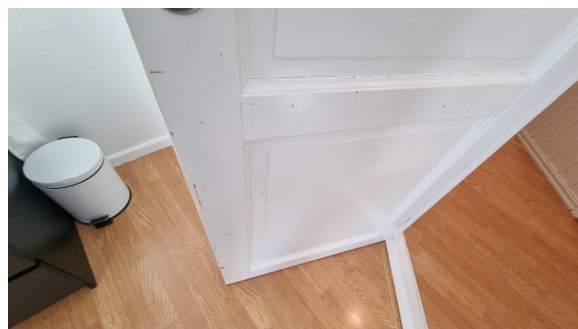
Enkelte av innvendige dører har noe slitasje.
