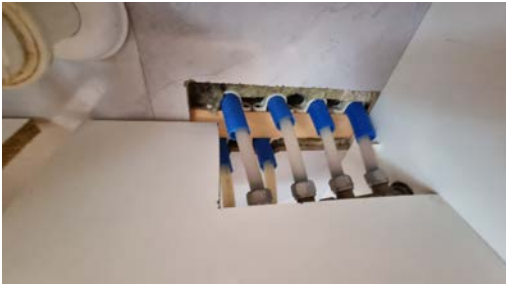
Fordelerstokk plassert i servantskap på bad.
