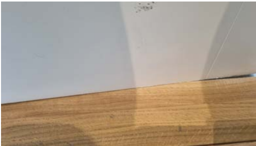
Enkelte dører subber mot karm/terskel.
