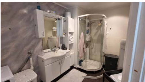
Badet må renoveres og bygges opp i henhold til gjeldende krav i TEK17.
