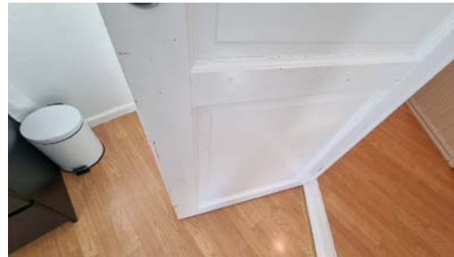
Enkelte av innvendige dører har noe slitasje.
