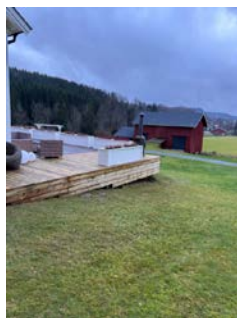
Mangler rekkverk på deler av terrasse
