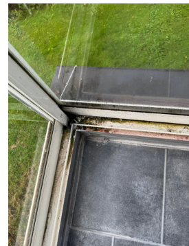
Lekkasje i vinduer i vinterhage
