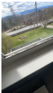
Kondensmerker på enkelte vinduer.
