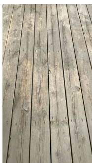
Det er værslitt/oppsprukket trevirke/trepaneler.
