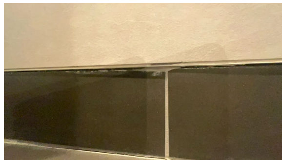
Manglende silicon mellom topp sokkelfils og bunnprofil på våtromsplate.
