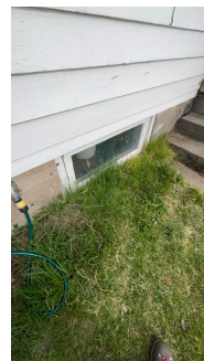
Lav høyde mellom terreng og kjellervinduer.
