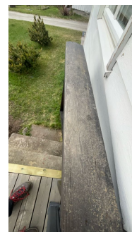
Det er værslitt/oppsprukket trevirke/trepaneler.
