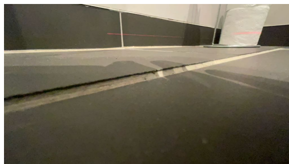
Sprang i enkelte flisfuger.
