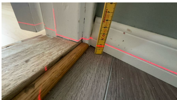
Helningsavvik på 18 mm ble målt i loftstue.
