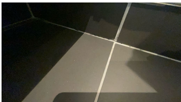
Sprekker/riss i fuger registrert.
