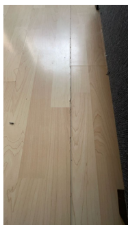
Sprekk i skjøt på laminatgulv på soverom i loftetasje.
