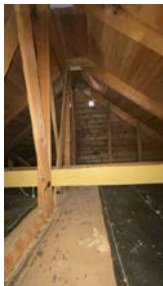
En stk lufteventil observert i gavelvegg.
