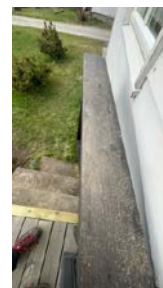
Det er værslitt/oppsprukket trevirke/trepaneler.
