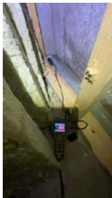
Fuktmåling ble foretatt, jeg målte skadelig fukt.
