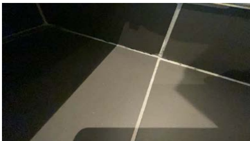
Sprekker/riss i fuger registrert.
