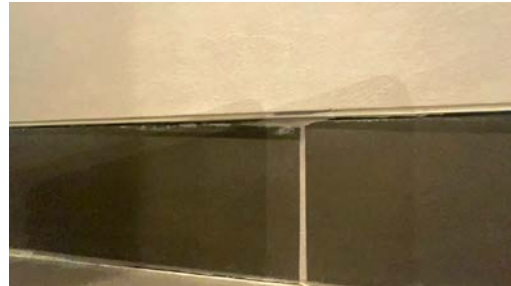
Manglende silicon mellom topp sokkelfils og bunnprofil på våtromsplate.
