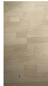
Gulv er feilmontert enkelte steder.
