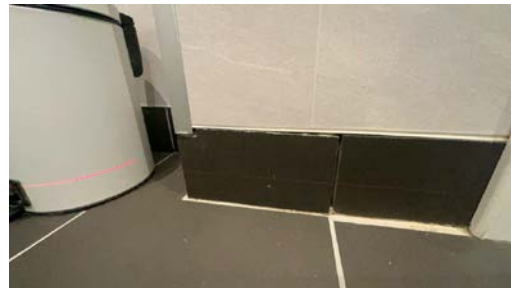
Manglende fugemasse på sokkelflis.
