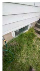
Lav høyde mellom terreng og kjellervinduer.
