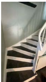
Det mangler håndløper på vegg i trappeløpet.
