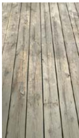
Det er værslitt/oppsprukket trevirke/trepaneler.
