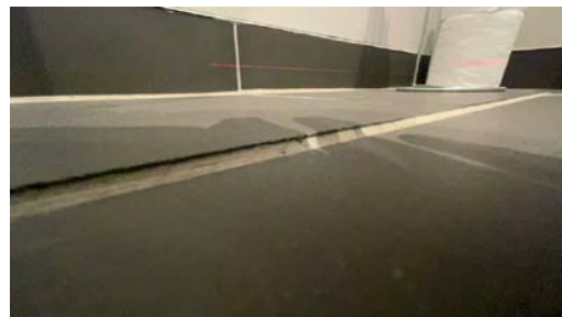
Sprang i enkelte flisfuger.
