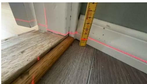
Helningsavvik på 18 mm ble målt i loftstue.
