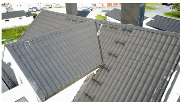
Takstige er ikke montert i henhold til monteringsanvisning
