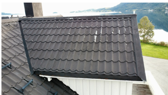
Lakkslipp på takplater
