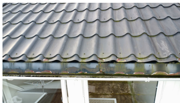
Lakkslipp/rust i forkant av takplater og raftebeslag
