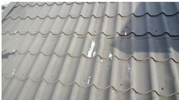
Lakkslipp på takplater
