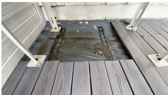
Membran er synlig under varmepumpe
