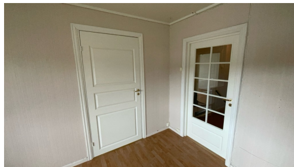
Dør til soverom 2/stue 2 og gang sett fra stue i 2. etasje. Dør til gang tar i karm
