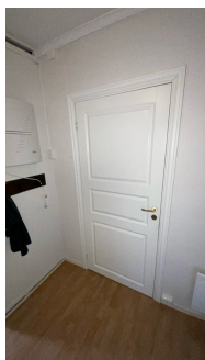
Dør til kjøkken sett fra gang i 2. etasje. Tar i karm
