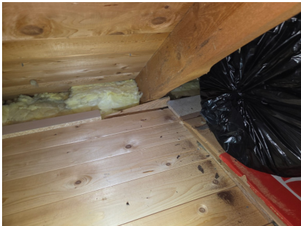
Begrenset ventilering av takkonstruksjonen
