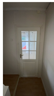
Dør til allrom sett fra gang i 2. etasje. Tar i karm
