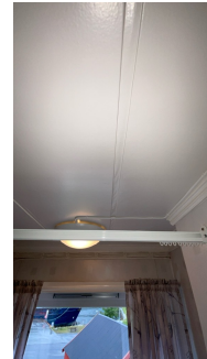
Folie på takplater er løsnet i skygge på plater
