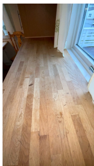
Overflateslitasje og merker i benkeplate
