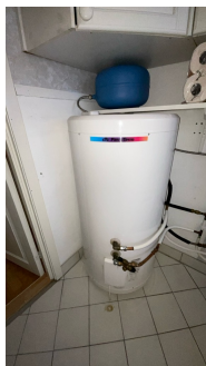
Varmtvannstank og ekspansjonstank
