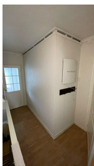
Kjølerom sett fra gang med synlige luftespalter for god ventilering
