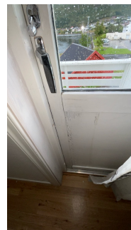
Synlig slitasje/skader innvendig på balkongdørloft
