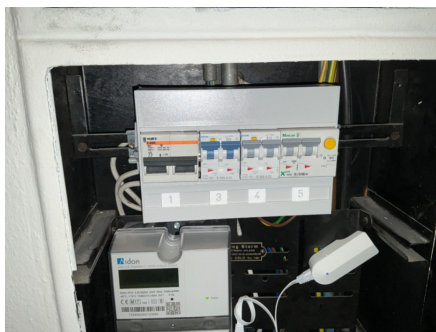
Automatsikringer i sikringsskap plassert i gang/fellesareal.
