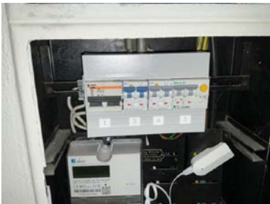
Automatsikringer i sikringsskap plassert i gang/fellesareal.
