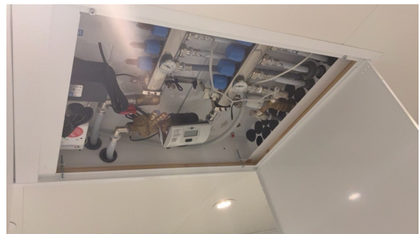
Fordelerskap i himling på bad.
