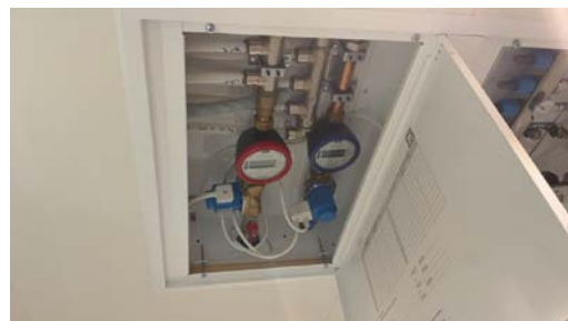
Fordelerskap i himling på bad.
