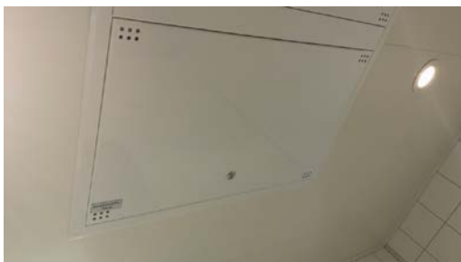
Fordelerskap i himling på bad.
