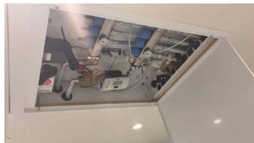
Fordelerskap i himling på bad.
